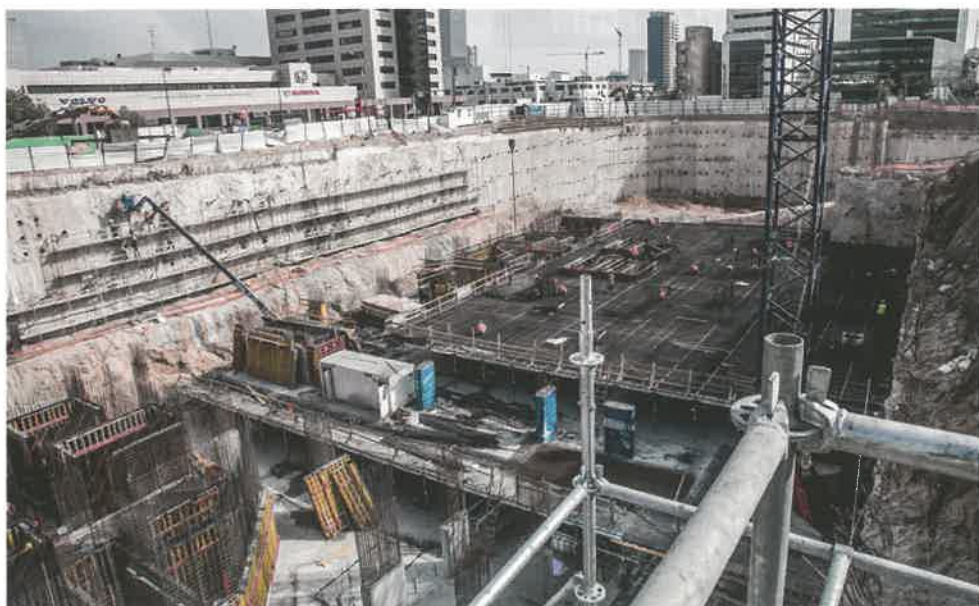
Il peso del GFRP è ¼ dell'equivalente in ferro e ha permesso di eseguire con relativa facilità l'integrazione di tiranti in GFRP in un "Cantiere Acrobatico", presso Rubinshtein Building Project Tel Aviv
